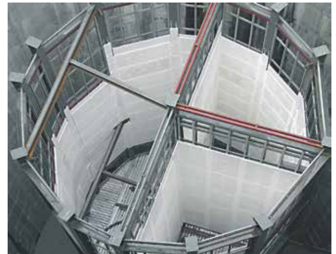
Pozos de ventilación Túnel sur M-30 BY-PASS, Madrid
